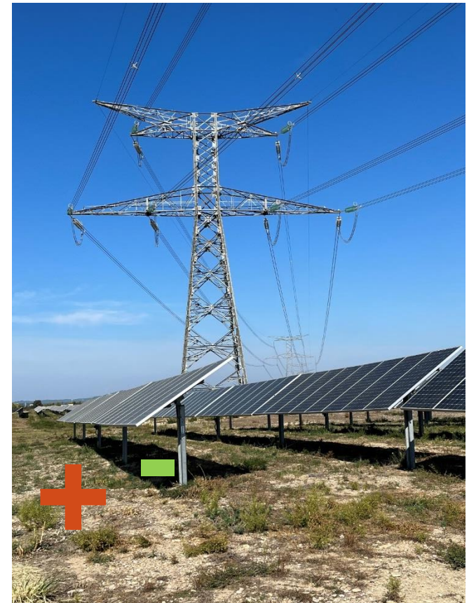
Centrale photovoltaïque avec trackers de la CNR, Caderousse, Vaucluse.
