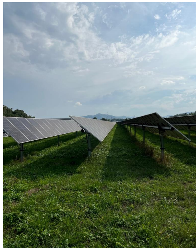
Centrale photovoltaïque avec trackers de la CNR, Pouzin, Ardèche.
